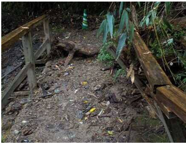
倒木・法土の状況
